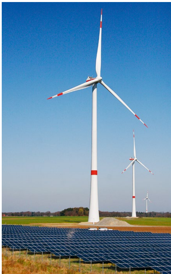
Neue Anlagen nach Repowering 2016 im Wind- und Solarpark Debstedt.
